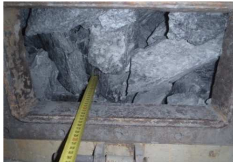
Figure 4 - Vues du vide annulaire par les trappes de visite du bouclier (à 4,20 m du front) dans le quart supérieur gauche (photo de gauche) et dans le quart supérieur droit (photo de droite)
