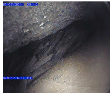
Figure 5 – Ecailles de calcschistes accumulées entre le rocher (en haut à gauche) et le revêtement (en bas à droite) dans le quart supérieur droit
